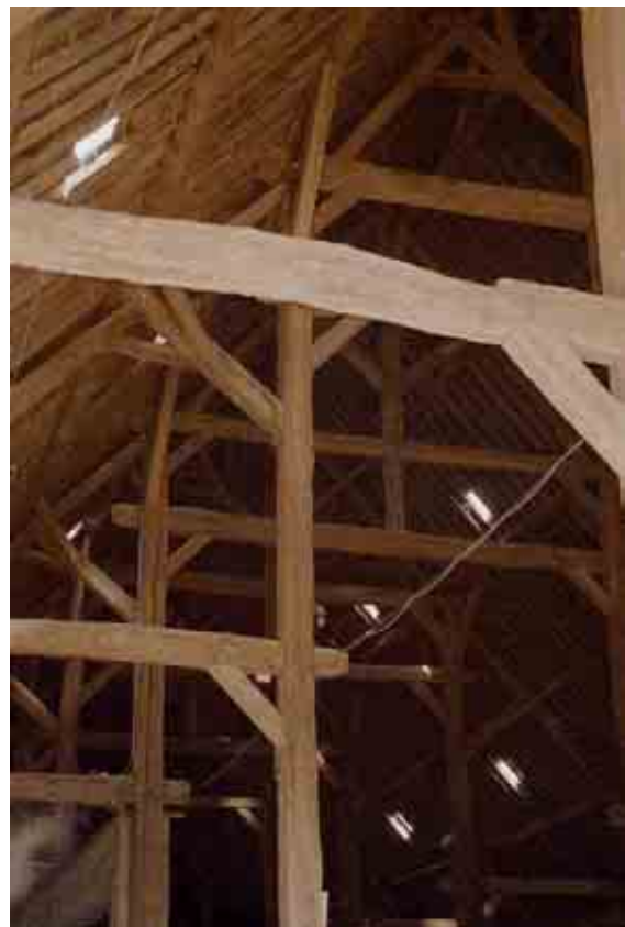
32. Vue de détail de l'intérieur de la grange avec sa remarquable charpente en bois.
